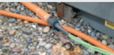
Von R&M speziell für Salto Natale assemblierte Kabel
