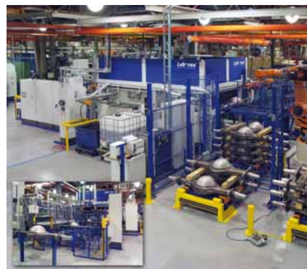
Complete reinigingsinstallatie DAF Westerlo
