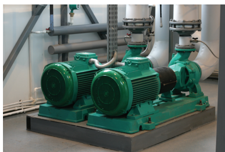
HLK-Systeme, Pumpen und Ventile
